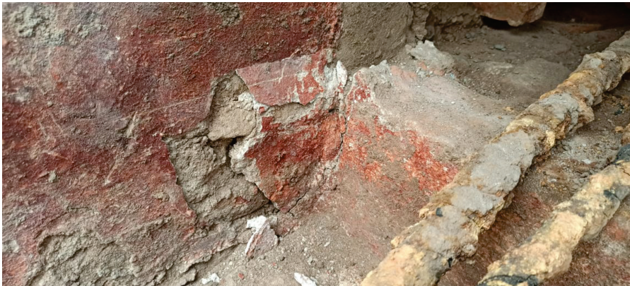
Figura 8. Suciedad impregnada y eflorescencias a causa de las antiguas conexiones de agua.
