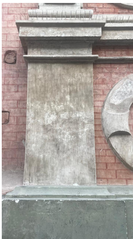
Figura 6. Evidencia de humedad en el pilar. Lugar: Fachada de la iglesia de Nuestra Señora de la Soledad.
