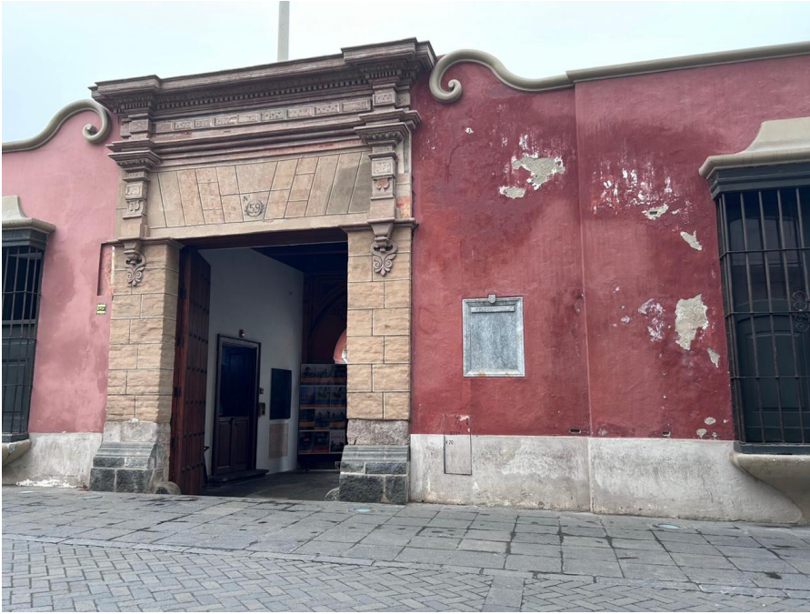
Figura 7. Manchas de humedad que conllevó a la aparición de sales y desprendimiento del estrato pictórico. Lugar: Fachada de la Asociación de Artistas Aficionados (Centro Histórico de Lima).
